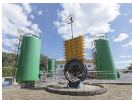
Figura 62. Estación de bombeo. C.R. Surandévalo
